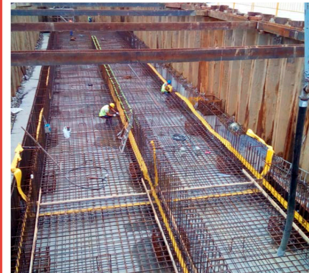
Obras del tanque de tormentas construido por la Autoridad Portuaria en el Puerto de Ferrol.
